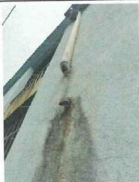
Foto 1: Vista de tubo de agua fluvial dañado que reencausa el agua al deposito de agua (tinaco).
