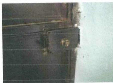
Foto 2: Chapas de puertas que se encuentran inservibles y que necesitan ser cambiadas.
