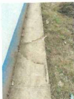
Foto 3: Vista de banqueta exterior que requiere reparación
