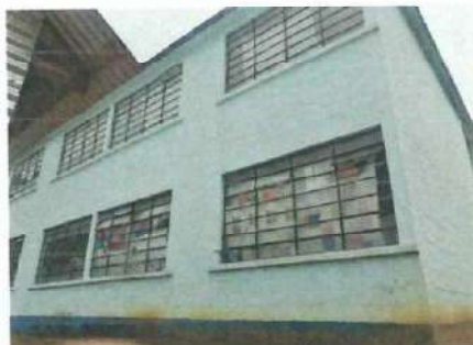
Foto 4: Vista de ventanas que necesitan bacones para brindar mayor seguridad al establecimiento.
